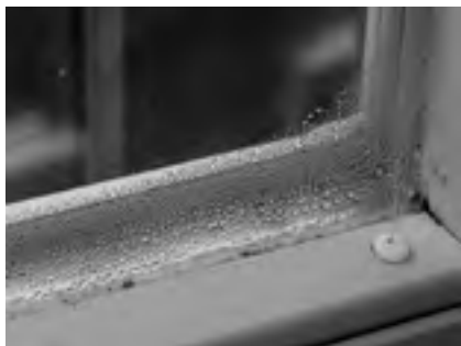
Obr. 1 Kondenzace vodní páry na okenní výplni a tvorba plísně v místech s tepelným mostem (zdroj: K. Klánová)
