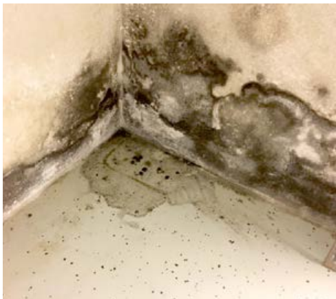
Obrázek 3 Plíseň ve stavbě, v soklové oblasti místnosti.
