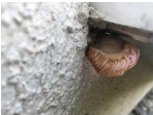
Obrázek 5 Dřevostavba – dřevokazná houba pod vnějším okenním parapetem.
