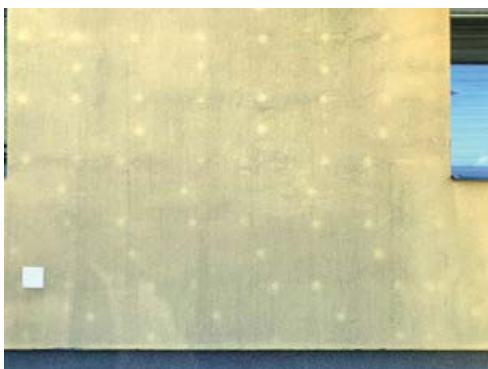
Obrázek 6 Návětrná západní strana fasády dodatečně zatepleného bytového domu postižená biotickým napadením.
