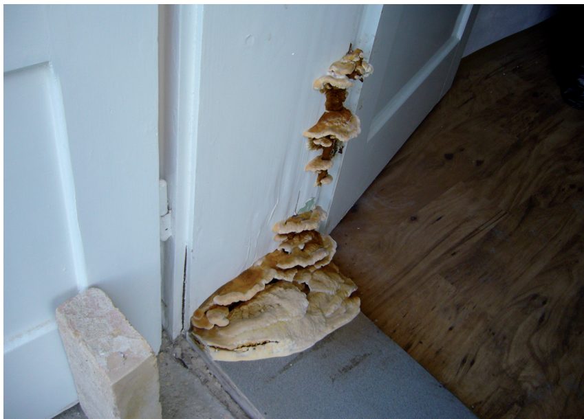
Obr. 6 Dřevomorka v dřevěné zárubni
