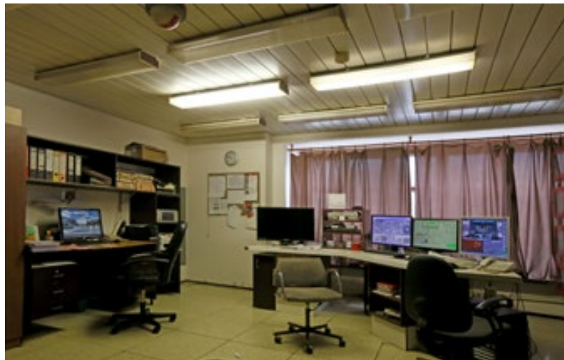
Severočeské divadlo opery a baletu Ústí nad Labem. Technický velín. Foto Dana Čecháková, 2017
