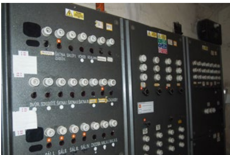
Kino Hodkovice nad Mohelkou. Ovládání elektroinstalace. Foto Vít Pokorný, 2019
