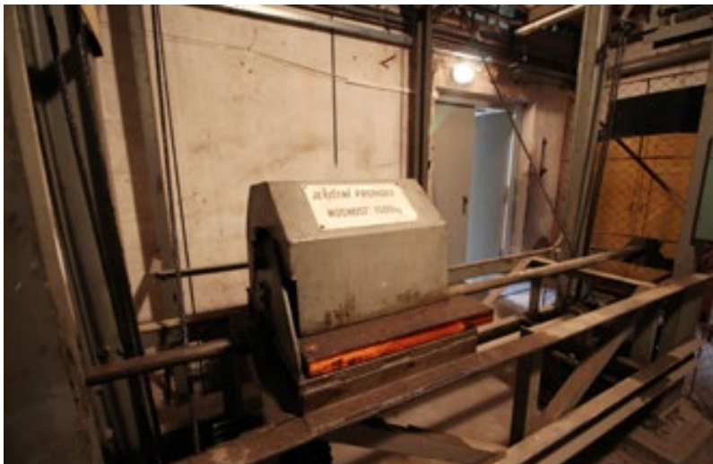
Městské Tylovo divadlo v Kutné Hoře. Mechanika propadla pod jevištěm Hlavního sálu. Foto Eliška Fuxová, 2017
