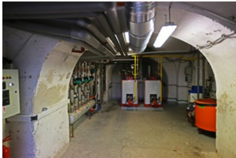
Kulturní dům Říp Roudnice nad Labem. Kotelna. Stav před zásadní rekonstrukcí objektu, uskutečněnou v l. 2018 – 2020. Foto Dana Čecháková, 2017
