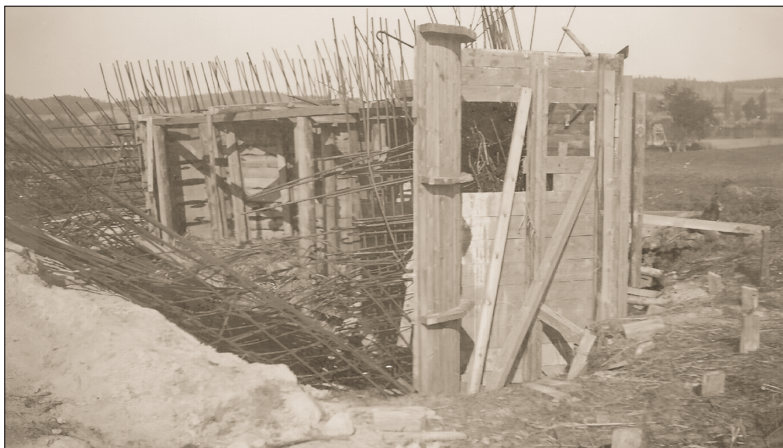
Pohled na jedno ze stavenišť objektu LO v oblasti jižních Čech, které je již částečně rozebráno. Na snímku je dobře vidět vnější bednění s nosnými sloupky, ramená a rozpěrami, které zajišťovaly stabilitu celé tesařské konstrukce.
