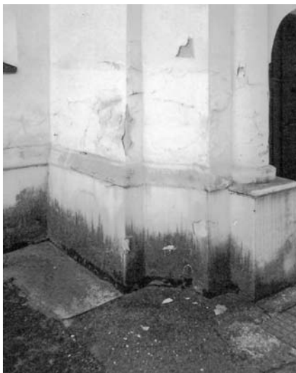
Obr. 5 Ukázka negativního vlivu srážkové vody na soklovou část objektu kostela – zamokření povrchu vodou
