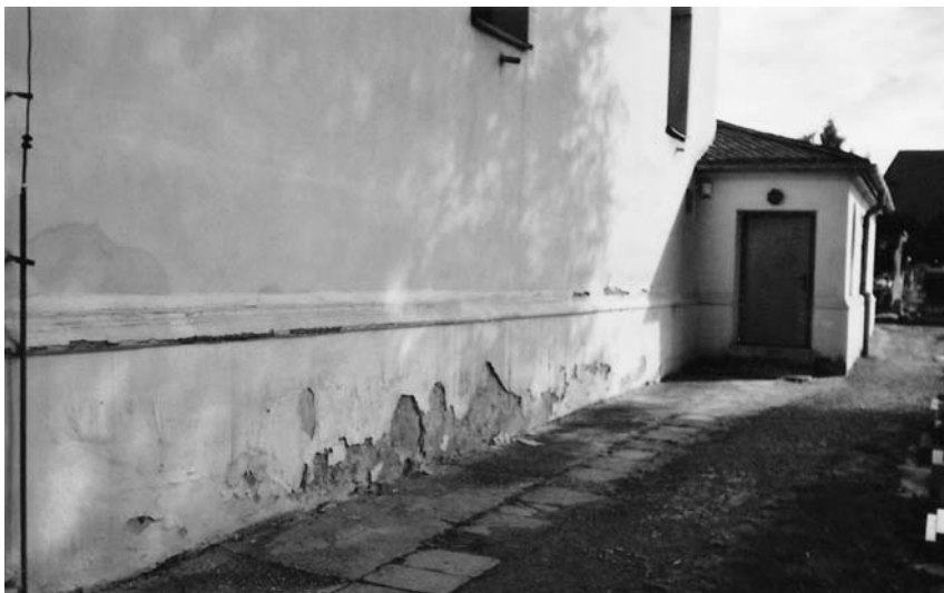
Obr. 4 Ukázka negativního vlivu srážkové vody na soklovou část objektu kostela – odpadnutá omítka
