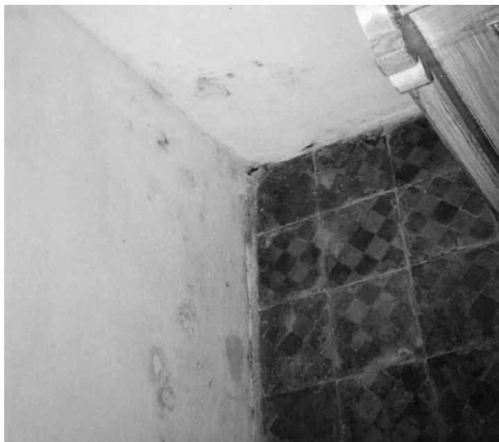
Obr. 9 Kondenzace vodní páry na povrchu stěny v blízkosti podlahy (objekt s vysokou tepelnou setrvačností)
