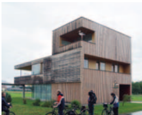
Obr. 2.6 Černá plíseň na východní straně modřínové fasády. Vodorovně položená prkna hůře vysychají a jsou proto mnohem více ohrožená než vertikálně rozmístěná dřevěná obkladová na severní straně.
