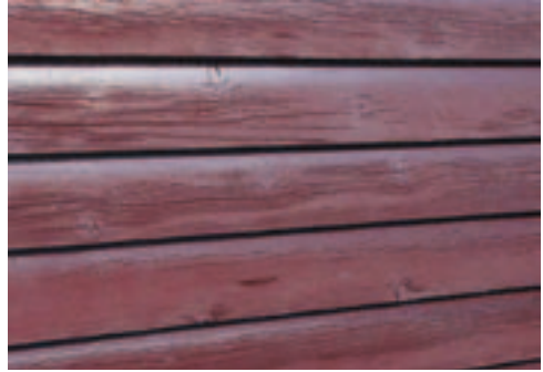
Obr. 2.8 Dřevěná fasáda budovy v přístavu. Tím, že je fasáda vystavena stálé expozici proměnlivého slunečního svitu a počasí, dřevo se vyluhuje a nevyhnutelně vznikají trhliny.
