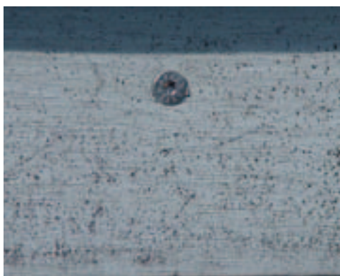
Obr. 2.7 Plíseň na dřevěném panelu. Vysoké ohrožení se vyskytuje na místech s nízkým slunečním osvětlením a v bezvětrí.
