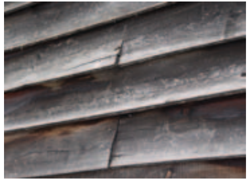
Obr. 2.4 Asi 15 let stará fasáda řadového domku v Bregenzu. Zřetelně jsou vidět trhliny, které se tvoří v místech spojovacích součástí, především tam, kde nejsou předvrtány otvory, resp. tam, kde nejsou dodrženy vzdálenosti spojovacích součástí od okrajů a konců prken.
