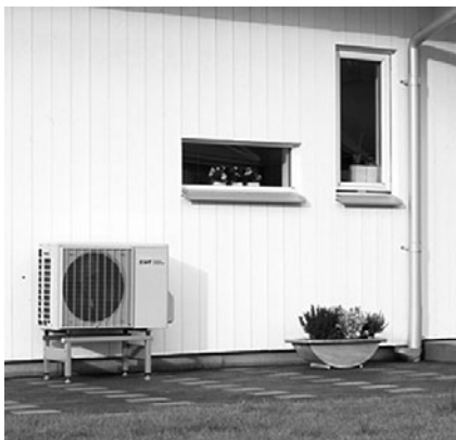
Obr. 5 Tepelné čerpadlo vzduch/vzduch – venkovní jednotka
