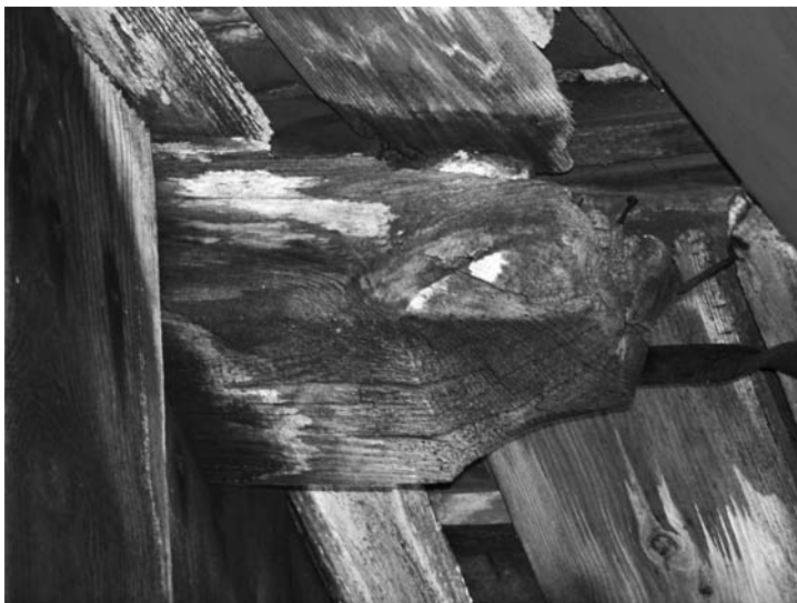
Obr. 4 Poškození krovu způsobené zatěnkáním po krokách
