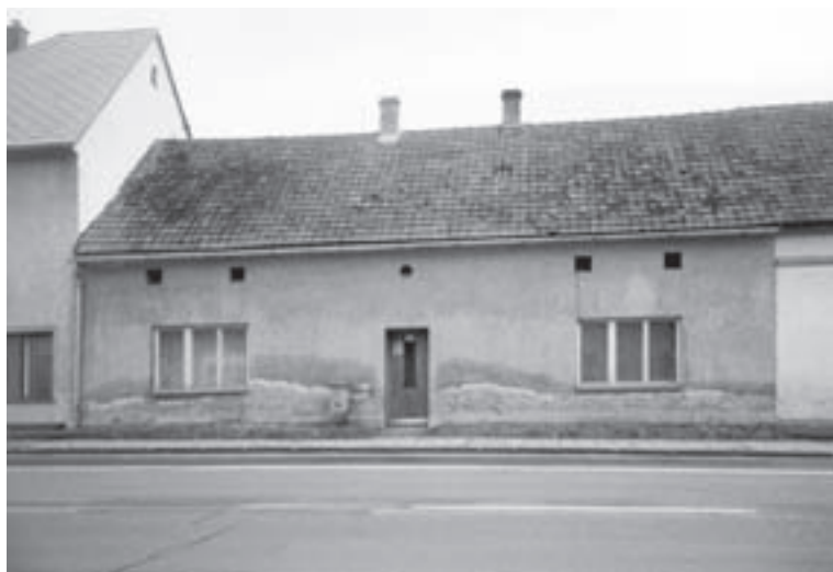
Obr. 1 Pohled na průčelí domu s viditelnou vlhkostní mapou
