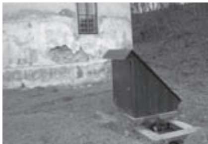
Obr. 2.1 Vysoká hladina podzemní vody a její negativní vliv na vlhkost zdiva u blízkého objektu
